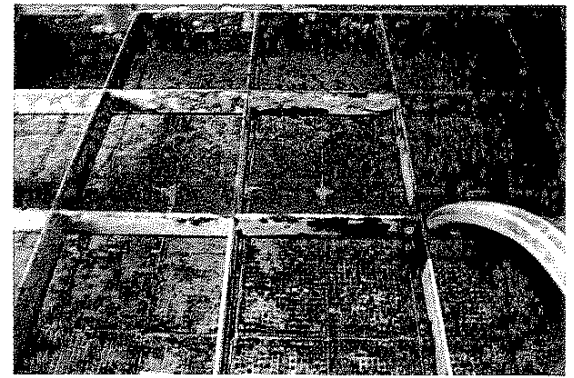
Abb. 7: Nach ca. 12.000 Betriebsstunden (Reinigung mit Wasser)
