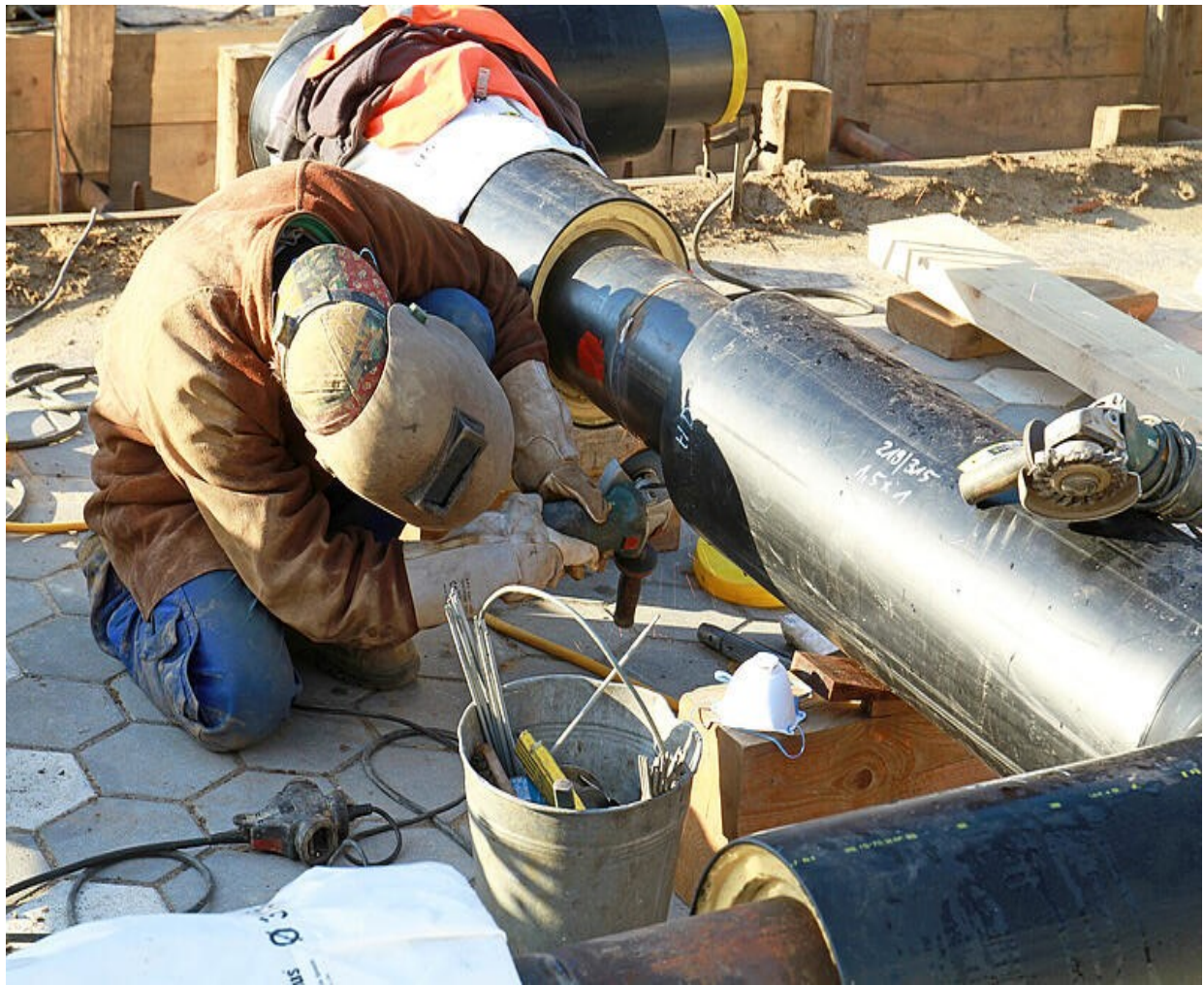
Foto: WVV/SKZ | Fernwärmeausbau ermöglicht eine intensivere Nutzung vorhandener Abwärme für industrielle Prozesse und die Gebäudetemperaturregelung bei gleichzeitig geringen Betriebs- und Wartungskosten.
